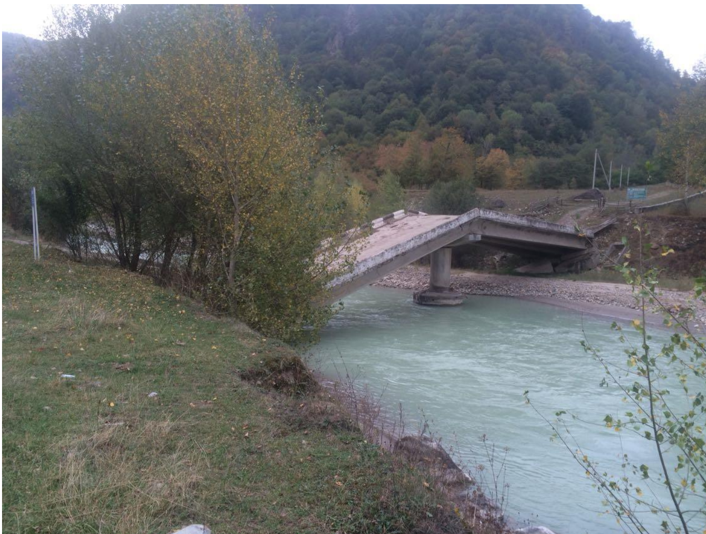
Фото 16. Разрушенный мост через р. Кубань в 25,7 км выше а. Каменноостский.
