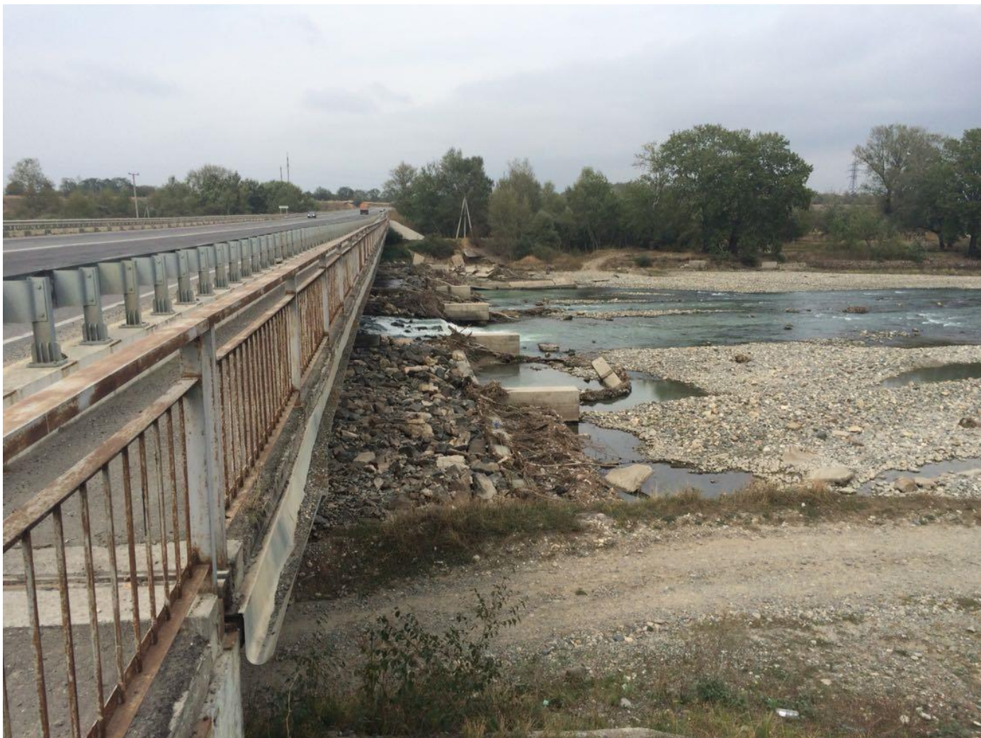
Фото 28. Разрушенные габионы из металлических сеток.
